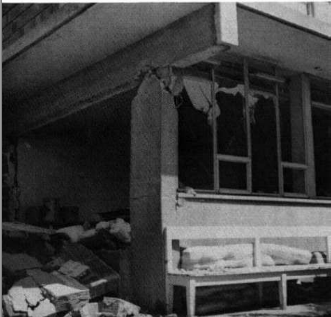
Fig.3 : Rottura a flessione e taglio dei pilastri per le tamponature parziali in altezza (da [5]).
