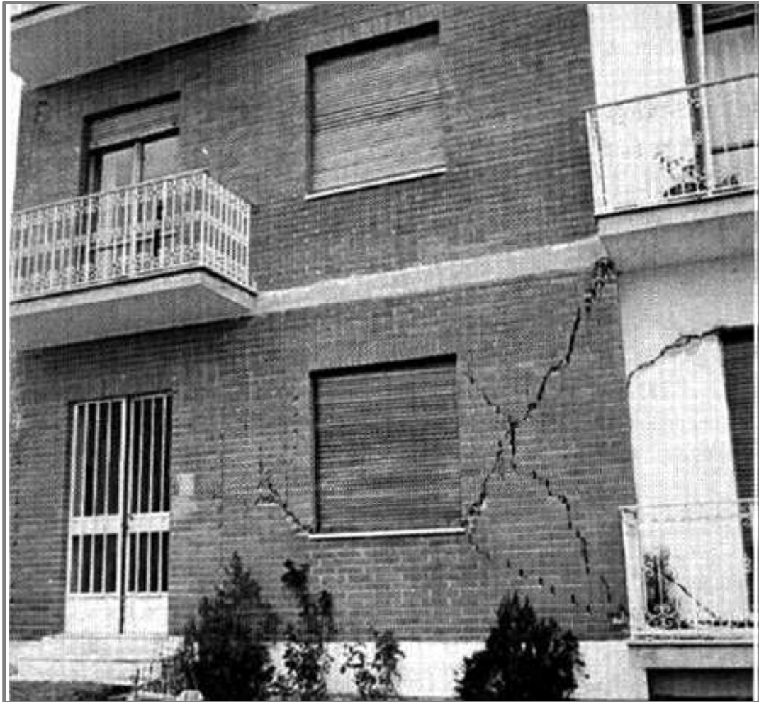
Fig.5: Danneggiamento delle tamponature con la struttura integra (da [41]).
