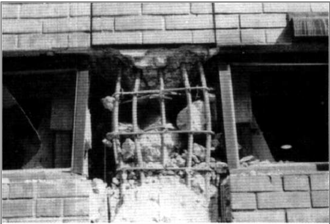
Fig.6: Rottura a taglio del pilastro per le tamponature parziali in altezza (da [83]).
