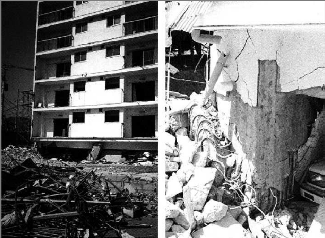
Fig.7: Crollo completo del piano terra a pilotis (da [65]).
