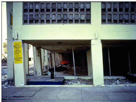
Lesioni causate dal fenomeno del "piano soffic".
