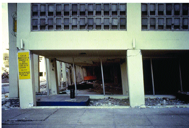
Caso reale di collasso per cedimento dei pilastri.
