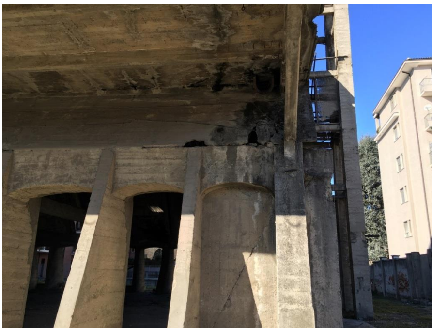
Figura 1.1 – Particolare del Paraboloide visto dall’esterno in cui è possibile notare il degrado avanzato in cui versa la struttura.
