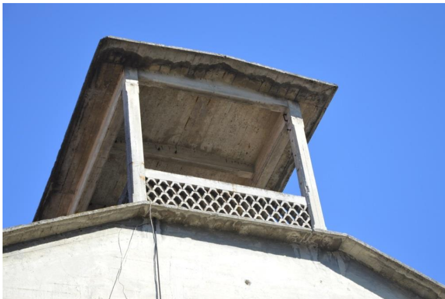
Figura 2.13 - Particolare della galleria superiore del Paraboloid vista da uno dei due prospetti frontali.
