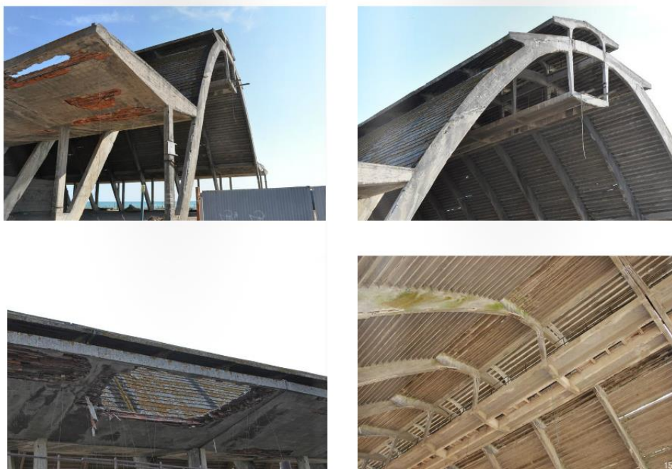
Figura 2.42 - Particolari del degrado del Deposito di Porto Recanati, ad Ancona. 1
