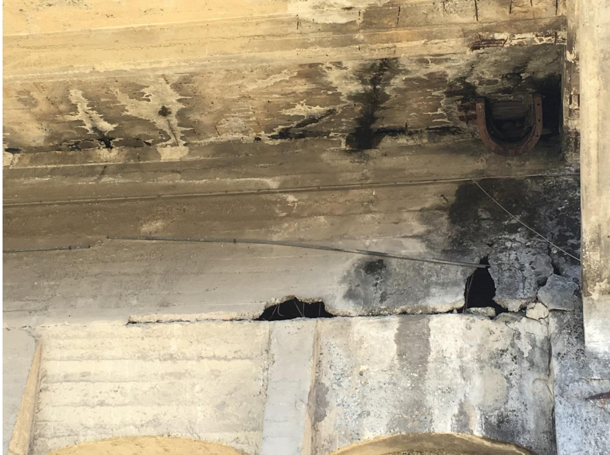
Figura 3.1 - Particolare visto dall'esterno del Paraboloide in cui sono evidente il degrado avanzato della struttura.
