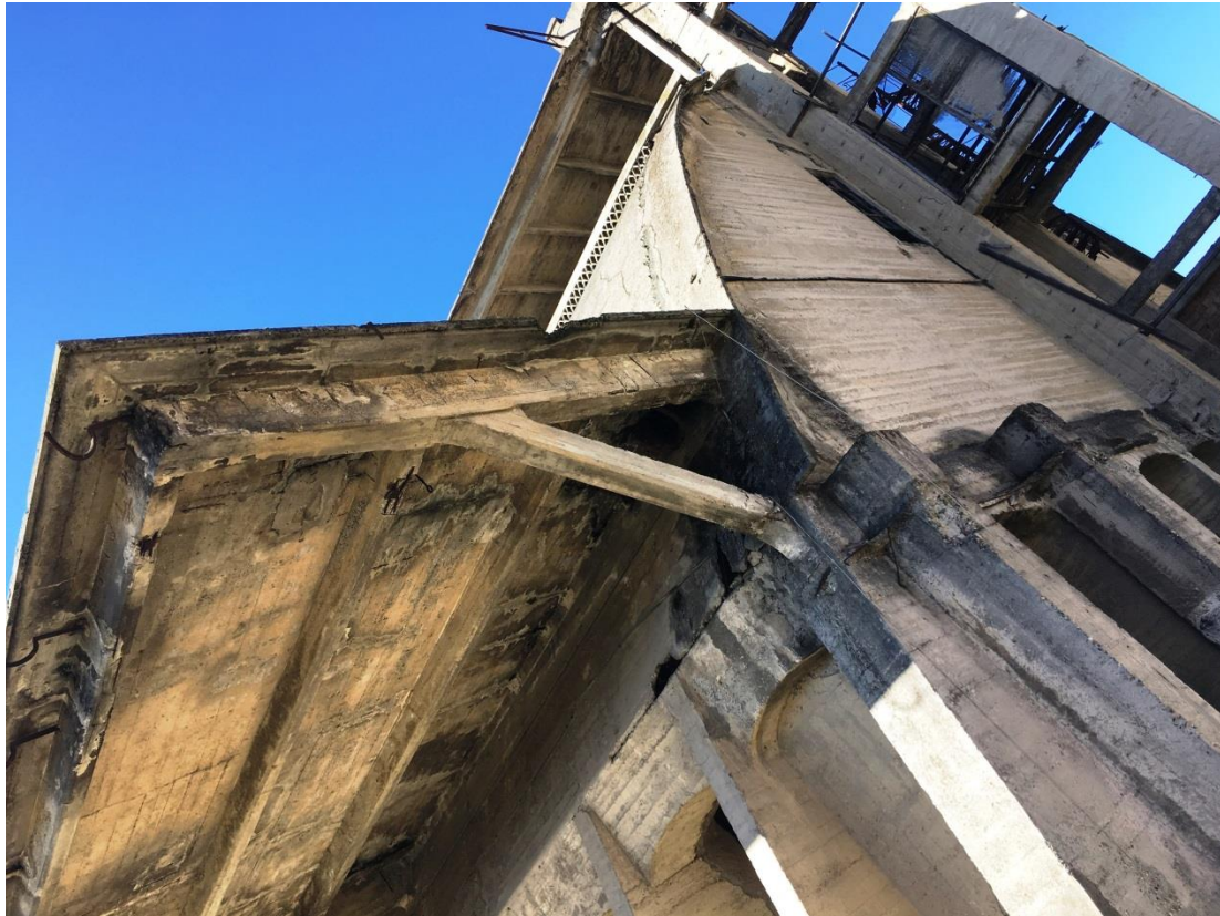
Figura 5.93 – Immagine dell'esterno del Paraboloido in cui è evidente in primo piano l'avanzato degrado strutturale degli elementi che compongono una pensilina laterale.
