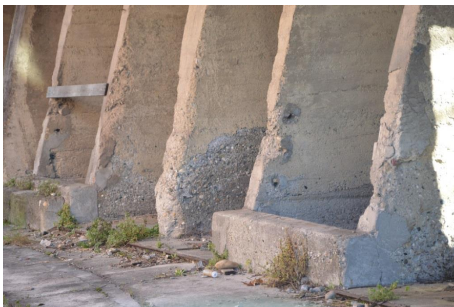
Figura 5.92 – Particolare della base di alcuni pilastri della struttura. E' molto evidente la riduzione della sezione di questi elementi strutturali a causa dei fenomeni di degrado.
